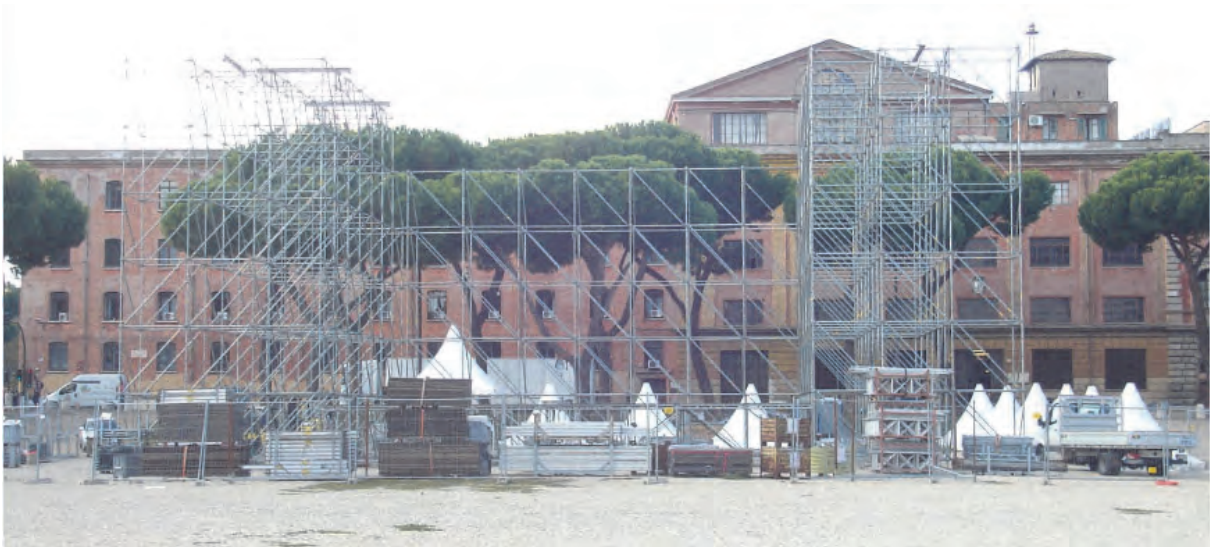
Figura 1.4 – 9 Esempio di palco (pedana e strutture verticali) realizzato con elementi di ponteggio multidirezionale
