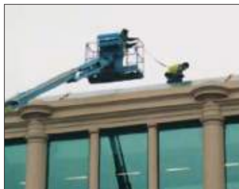
Figura 9 - Lavoro su una copertura con DPI anticaduta del lavoratore agganciato al cestello
